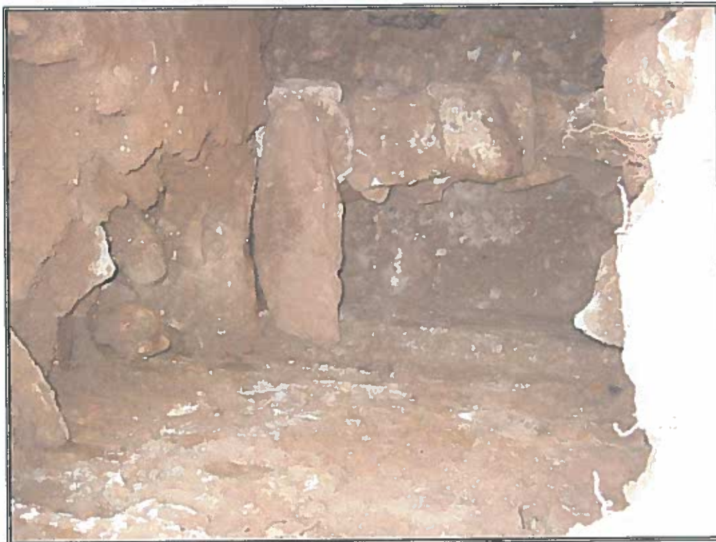
Foto 24. Canaletta di drenaggio e copertura in sassi poggiate da una parte sul cordolo e dall'altra sulla parete costruita in sassi a secco
